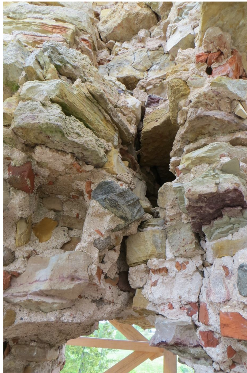
8. Ohtlik pragu laskekambri kohal. Vaade torni siseküljelt (06.2019)
